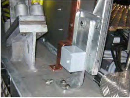
Abbildung 55: Sensor 4, unterer Bereich Trafo-Trennwand, li. des Zugangs
