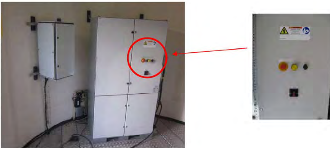
Abbildung 9: Darstellung des Steuer-Schaltschranks auf der Eingangsplattform des Turms
