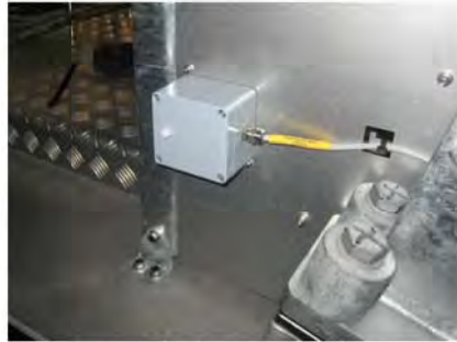
Abbildung 54: Sensor 2, unterer Bereich Trafo-Trennwand, re. des Zugangs
