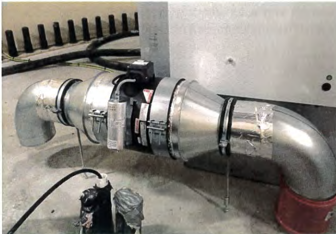
Abbildung 74: Axiallüfter mit Ansaug- und Druckrohr im Turmkeller neben Schaltanlage
