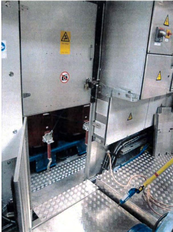
Abbildung 53: Ansicht der Zugangsschotts zum Transformatorraum, hinterer Bereich der WEA, Blick aus dem Maschinenhaus
