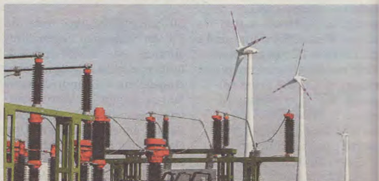
Mit dem Strom aus Theiß werden nach und nach Umspannwerke im ganzen Land wieder ans Netz gebracht.
