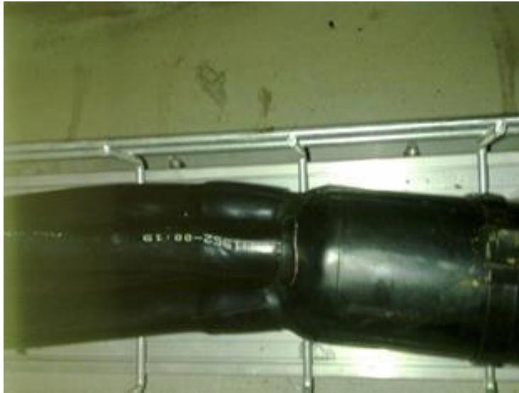
Abbildung 7-1: Risse im Schrumpfschlauch des Mittelspannungskabels.
